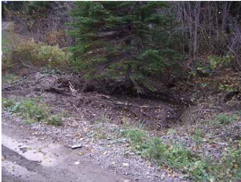
Photographie 6 : TC3, signe d'érosion à proximité du ponceau.
